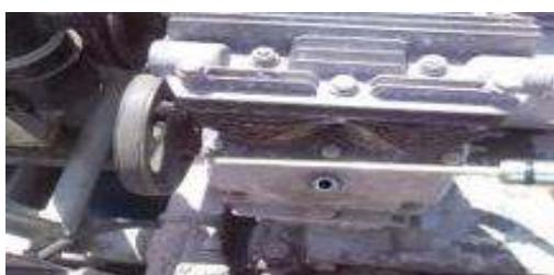
ΣΗΜΕΙΟ ΕΛΕΓΧΟΥ ΣΤΑΘΜΗΣ ΛΑΔΙΟΥ ΚΟΜΠΡΕΣΕΡ ΑΕΡΟΣ
